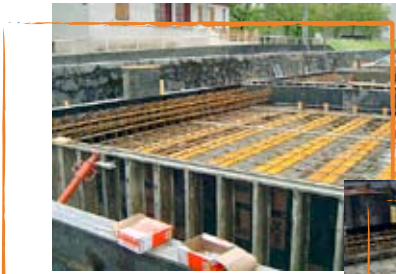
Le coffrage délimite le périmètre dans lequel le béton va être coulé.
