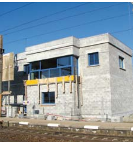
Futur poste de commande à distance, à Moirans.
