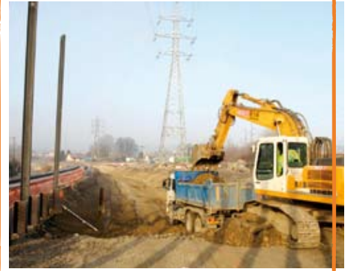
Le déblaiement peut commencer pour dégager l'emprise nécessaire à la construction de l'ouvrage.
